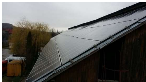
Fig. 1 Panouri fotovoltaice pe clădirea birouri
