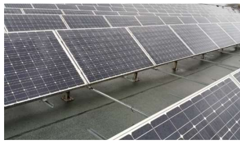
Fig. 2 Panouri fotovoltaice pe clădirea laborator.
