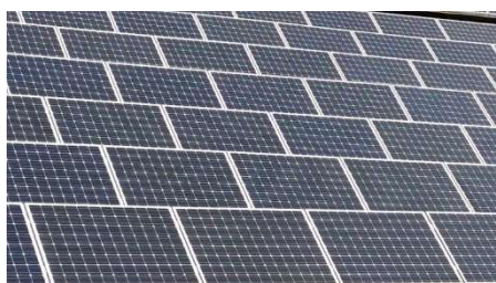
Fig. 4 Panouri fotovoltaice montate pe hala de producție
